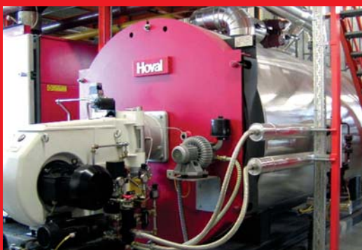
VA TECH HYDRO GmbH & Co, Weiz (Steiermark) Autriche Type de chaudière: Hoval Giga-3 (4000), Brûleur: brûleur bicombustible Elco Klöckner EK 8-550 GS, Combustible: gaz naturel H/mazout L. La Giga-3 est utilisée pour l'alimentation du réseau de chaleur à distance de la commune de Weiz.
