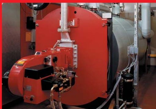
STARRAG, Teufenthal (CH) Type de chaudière: Hoval Giga-3 (1500), Brûleur: Weishaupt RGL 30/2-A-ARF, Combustible: gaz naturel H/mazout L. STARRAG fabrique des machines-outils de haute précision pour l'industrie aéronautique et spatiale. La Giga-3 fournit la chaleur pour le chauffage des ateliers de production.
