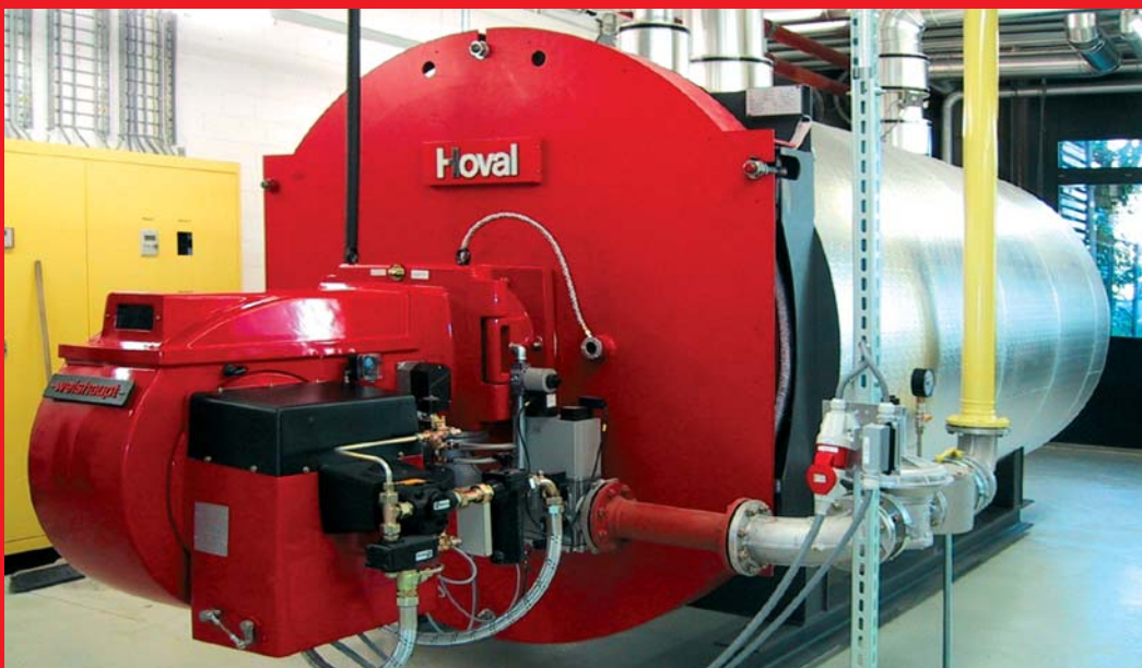
Unaxis AG, Balzers (FL) Type de chaudière: Hoval Giga-3 (3500), brûleur: Weishaupt RGL 60, combustible: gaz naturel/mazout. Unaxis AG est un des principaux fournisseurs d'unités de production dans le domaine des semi-conducteurs et de la techno- logie de couches minces. La Giga-3 est utilisée pour la production de chaleur industrielle et le chauffage des ateliers de pro- duction ainsi que des bâtiments de bureaux.
